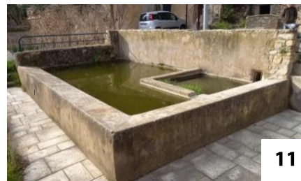
Fontaine Rue Pra de Pé
