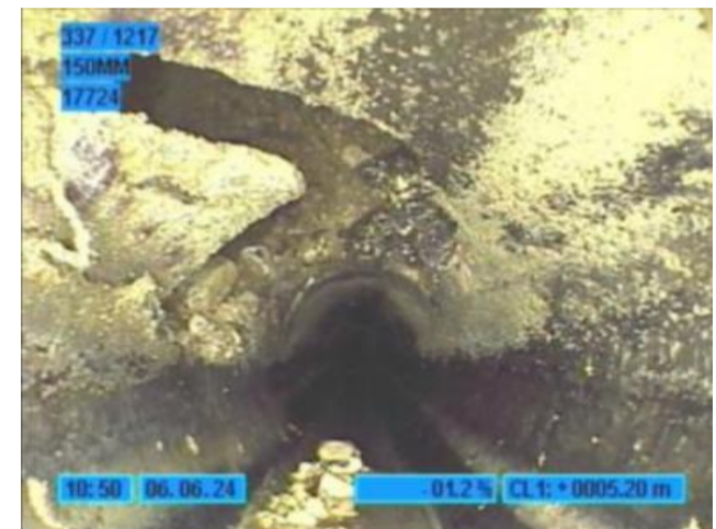
Figure 37 : Trou dans la canalisation
