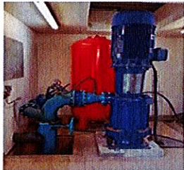
Station de pompage des Clastres Commune de Garéout
