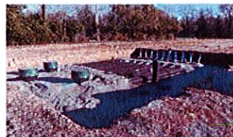
Filière agréée filtrer à sable nouvelle génération – Carcès
